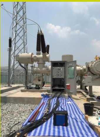
Messung an einer Schaltanlage
